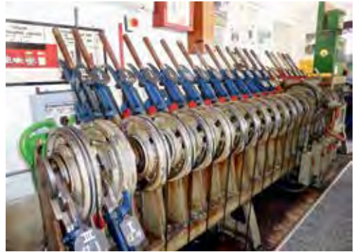
Hebelbank für Weichen und Signale im Stellwerk Nf Bad Neuenahr.
