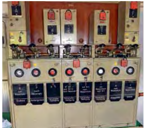
Blockeinrichtung im Stellwerk Nf Bad Neuenahr.
