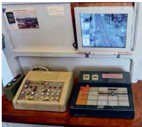
Ehemalige Überwachungseinrichtung Bahnübergang am Winzerverein im Stellwerk Df Dernau
