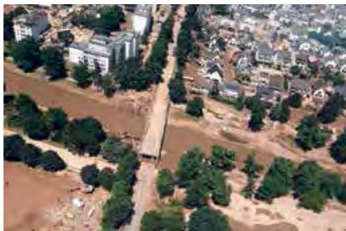
Die Ahrbrücke in Bad Neuenahr-Ahrweiler im Verlauf der Landesstraße 83 (rechts das Peter-Joerres-Gymnasium) wurde ebenfalls stark beschädigt. Sie musste im Widerlagerbereich in Richtung Königsfeld erneuert werden. Aufnahme datum: 21. Juli 2021
