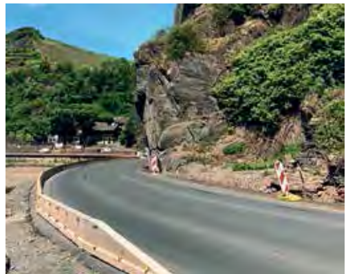
Die selbe Stelle an der „Bunten Kuh“ mit der erneuerten B 267. Aufnahmedatum: 18. Mai 2022
