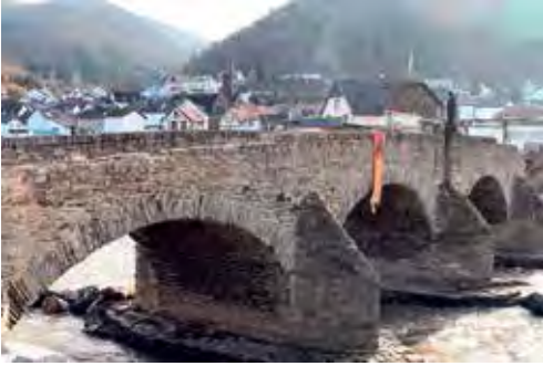
Ebenfalls zerstört: die Johannes-von-Nepomuk-Brücke in Rech, 18. Jahrhundert (Januar 2022)
