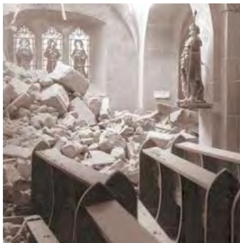
Ein Blick ins Innere der Pfarrkirche „St. Lambertus“ nach dem Kirchturmeinsturz
