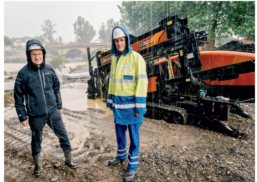
Bohrungen unter der Ahr zur Energieversorgung: Fabian Vocktmann, Regionalmanager der Westenergie AG Rauschermühle (rechts), mit Andreas Geron, Bürgermeister der Stadt Sinzig.
