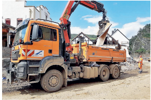
Aufräumarbeiten im Ahrtal: Zerstörte Straßen und Brücken mussten wieder befahrbar gemacht werden.
