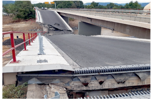
Die Ahrbrücke Sinzig im Verlauf der B 9 kurz nach der Flutkatastrophe
