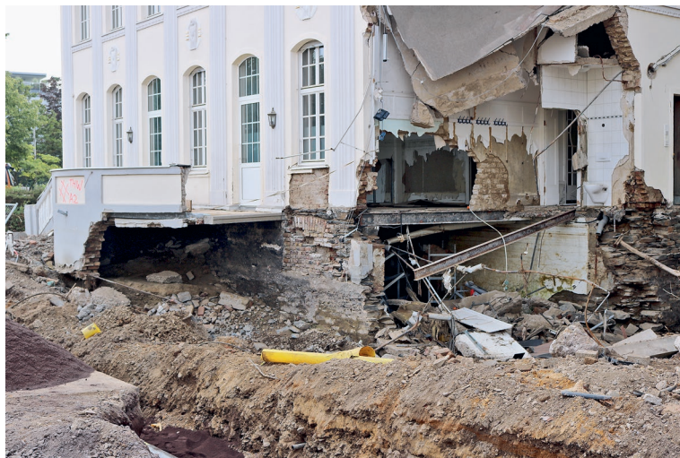
Zerstörte Hausecke und Freitreppe des Kulturdenkmals Felix-Rütten-Straße 2 im August 2021
