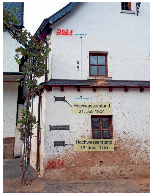
Wohnhaus in Dernau mit Marken historischer Hochwasser (1804 und 1910) sowie den Hochwasserständen vom Juni 2016 und Juli 2021
