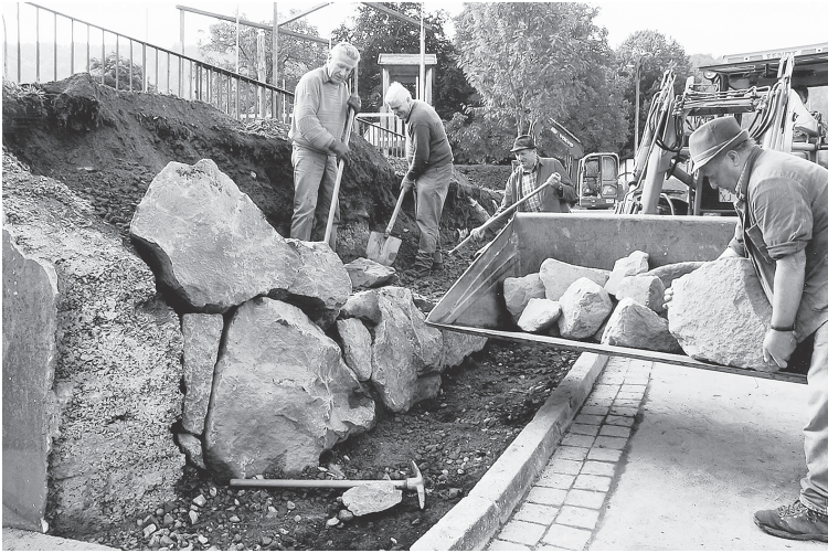
Die Hangsicherung am Kinderspiel- und Dorfplatz in Honerath erfolgte in Zusammenarbeit von Bürgern mit der Dorfgemeinde.
