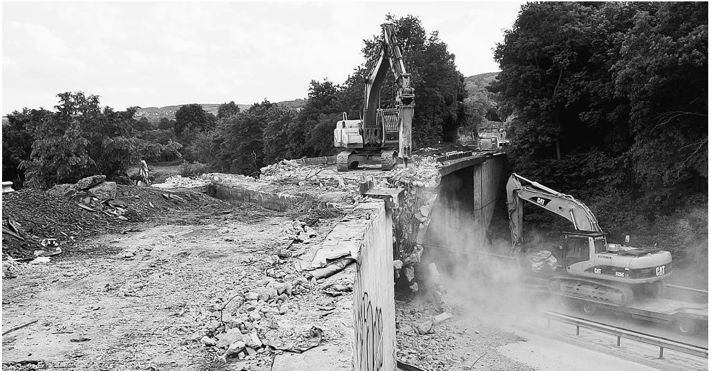
Schweres Gerät im Wochenenddienst: Die alte B 9-Brücke bei Remagen weicht einer neuen.
