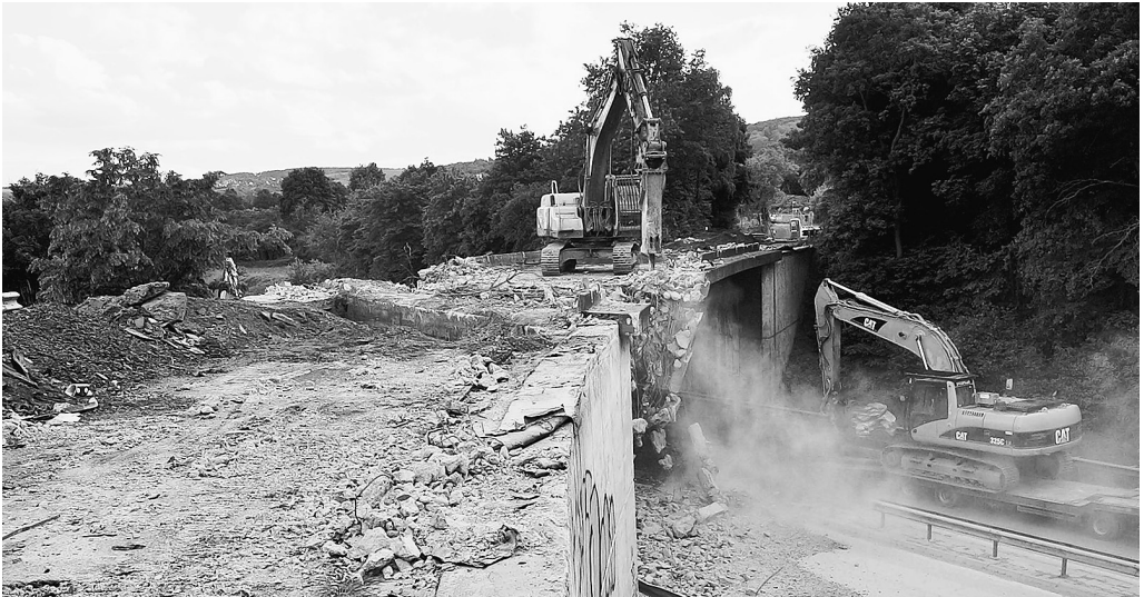
Schweres Gerät im Wochenenddienst: Die alte B 9-Brücke bei Remagen weicht einer neuen.
